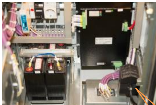
Низ шкафа управления
