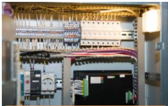
Верх шкафа управления
